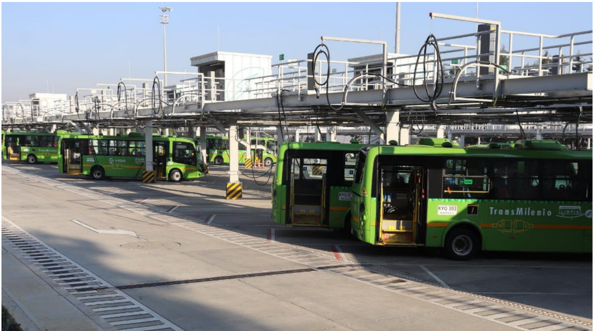
Figura 2: Vista del patio Perdomo con infraestructura de recarga vertical de plug-in .
