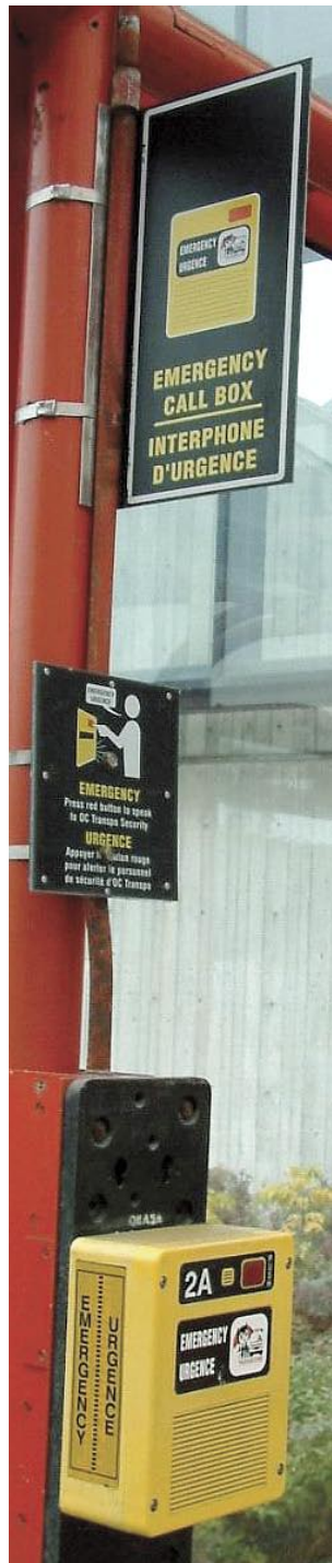
Fig. 12 Teléfonos de llamada de emergencia en Ottawa, Canadá Lloyd Wright
