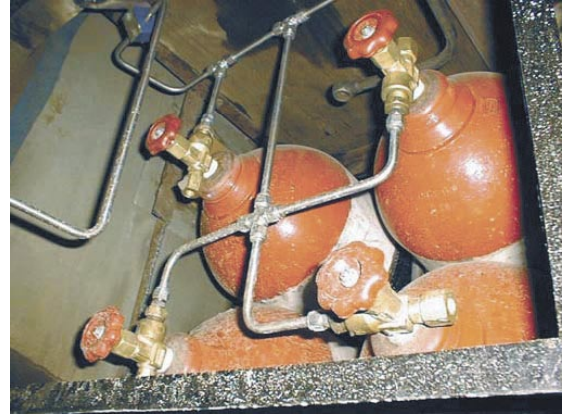
Fig. 3-2 Tuberías GNC en un bus convertido, sin abrazaderas de alivio de tensión.
