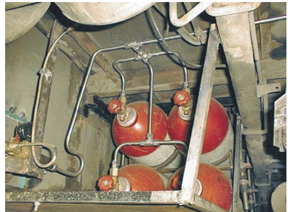
Fig. 3-3 Tubería GNC en un bus convertido, sin abrazaderas de alivio de presión y un insuficiente anclaje de cañerías de gas.
