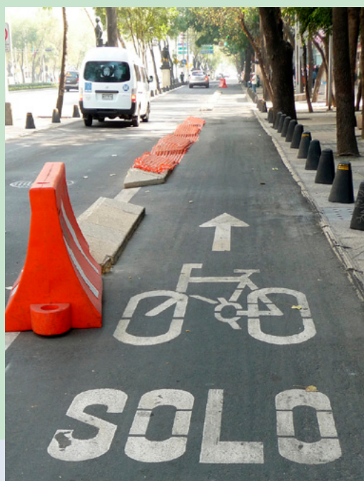
Figura 59: La Ciudad de México está mejorando la infraestructura ciclista para apoyar este modo de transporte energéticamente eficiente. Fuente: Manfred Breithaupt, 2010
