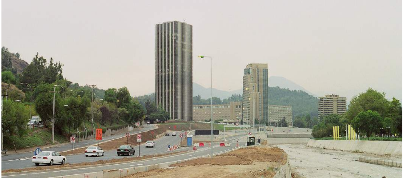
Figura 1. Construcción de la autopista Costanera Norte en Santiago, Chile. Foto: Claudio Olivares Medina
